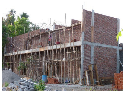
Figura 2. Një shtëpi murature të mbërthyer në ndërtim.
