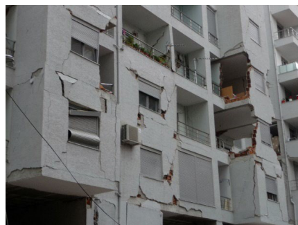
Figure 2. Muret mbushës të dëmtuara nga tërmeti, disa prej të cilave kanë rënë nga ndërtesa.
