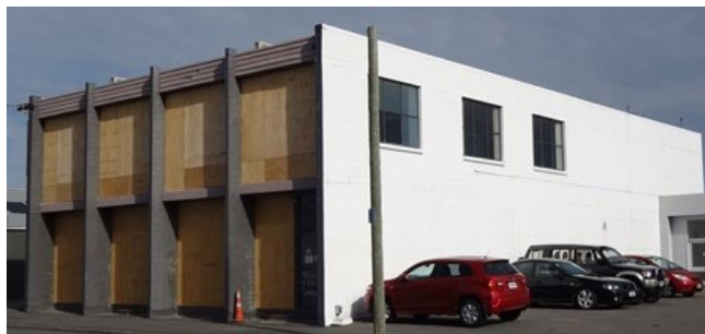
Figura 1. Një ndërtesë e dëmtuar nga tërmeti. Fortësia dhe ngurtësia e mureve me muraturë të bardhë gjatësorë kanë parandaluar dëmtimin. Një sistem strukturor më fleksibël që vepron tërthor me ndërtesën ka çuar në lëvizje më të mëdha dhe dëmtime në fasadën e përparme. Është e mbuluar përkohësisht me fletë kompensatë.
