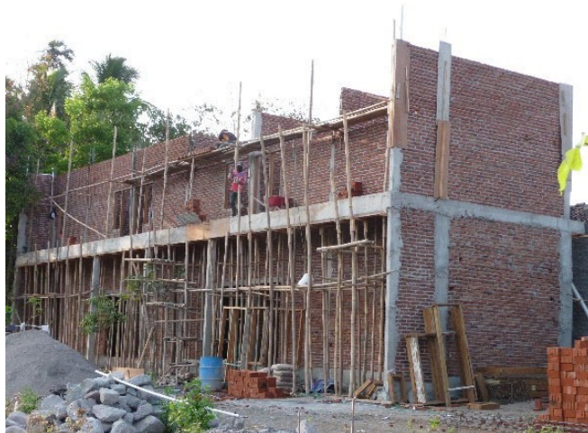
Figura 2. Një shtëpi murature të mbërthyer në ndërtim.
