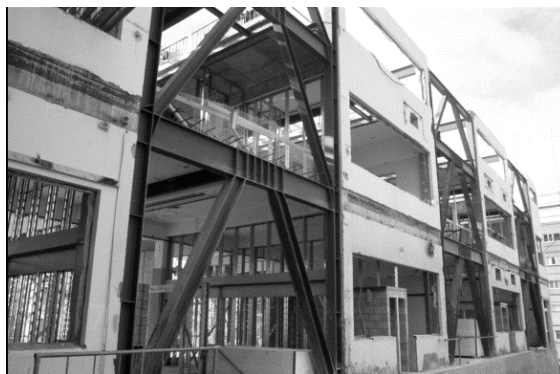
Figura 4. Në këtë ndërtesë janë futur kontraventime çeliku si pjesë e rinovimit.
