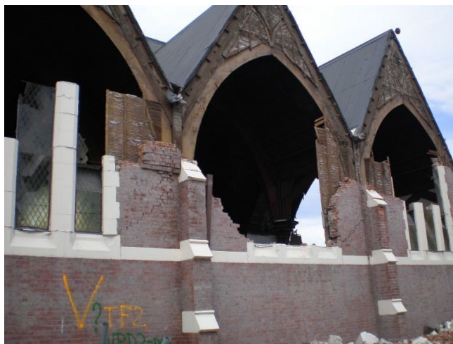
Figura 4. Një tërmet ka shkatërruar shumicën e mbulesës me tulla dhe xhamin e kësaj ndërtese.
