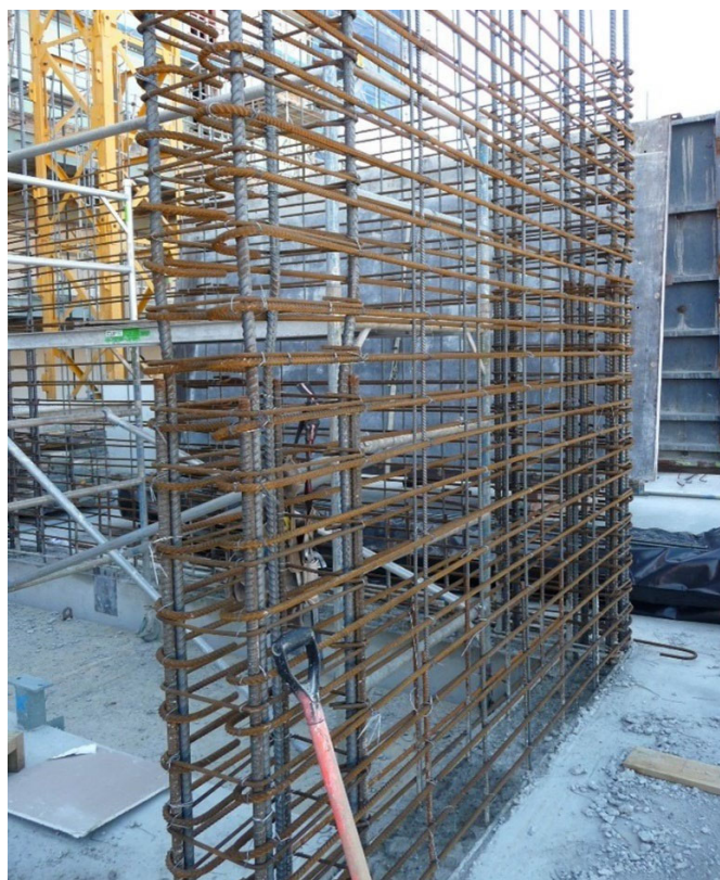
Figura 1. Dëmtime të rënda gjatë një tërmeti mund të ndodhin nëse mungojnë disa shufra përforcuese në këtë mur betoni të armuar.
