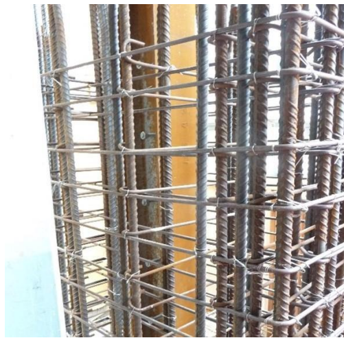
तस्वीर 3. स्तम्भों में कांक्रीट डालने से पहले स्टील से बनी छड़ें देखी जा सकती हैं। ये छड़ें नीचे से ऊपर की दिशा में होती हैं, और वलय (bending) का प्रतिरोध करती हैं। इसके अलावा धरती के समानांतर छड़ें कांक्रीट को टूटने और अलग होने से रोकती हैं।
