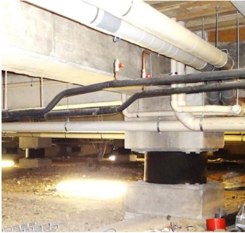
तस्वीर 2. मकान के नीचे काले रंग के दो बेलनाकार (cylindrical) विलगाव उपकरण (isolation devices) देखे जा सकते हैं। हर उपकरण आधारशिला और मकान के स्तंभ (column) से बोल्ट्स (bolts) के माध्यम से जोड़ा गया है।
