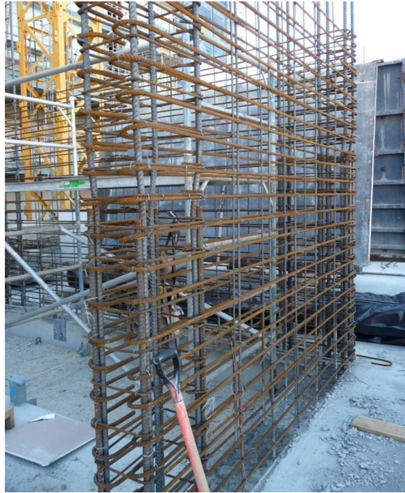
तस्वीर 1. अगर कई सारी स्टील की छड़ें प्रबलित कंक्रीट (reinforced concrete) की दीवार में न हों तो गंभीर क्षति हो सकती है।
