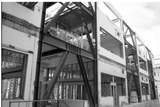
شکل ۴. دهانه‌های با مهاربند فولادی به‌عنوان بخشی از مقاوم‌سازی در این ساختمان تعبیه شده‌اند.
