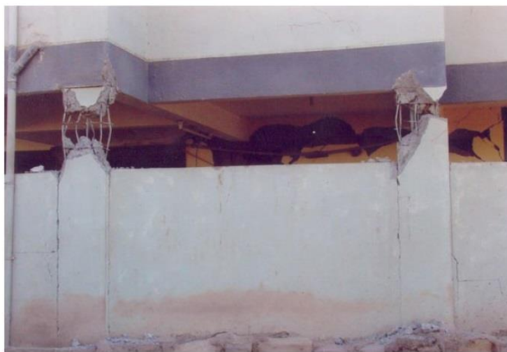
شکل ۴. ستون‌های کوتاه آسیب دیده در زلزله.
