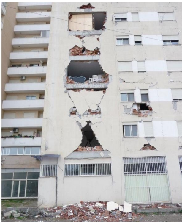
شکل ۲. مثالی از یک ساختمان آسیب دیده در زلزله که در آن دیوارهای میان‌قاب به‌طور سنجیده برای تحمل نیروها و حرکات لرزه‌ای طراحی نشده‌اند.
