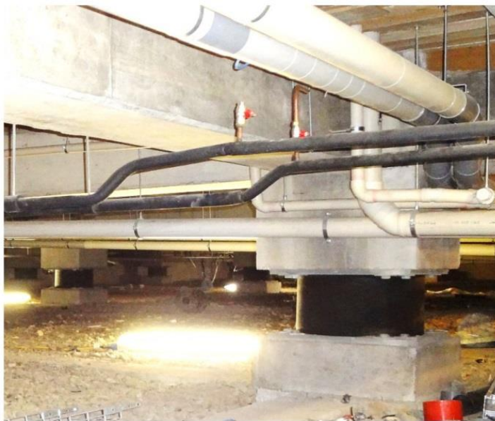
شکل ۲. دو تکیه‌گاه جداساز سیاه رنگ و استوانه‌های شکل در زیر یک ساختمان. هر تکیه‌گاه، از پایین به یک پایه بتنی که به پی متصل شده و از بالا به پای یکی از ستون‌های ساختمان پیچ شده است.
