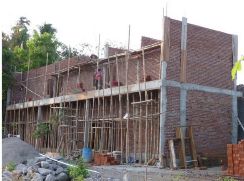
شکل ۴. ساخت و ساز سنگین رایج با استفاده از بتن مسلح و مصالح بنایی - در این مورد خاص ساختمان بنایی محصور شده.
