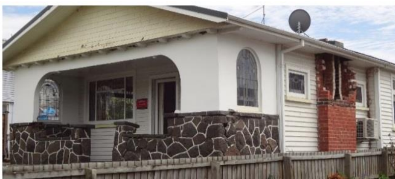
شکل ۳. یک دودکش آجری در تراز بام دچار شکست شده و سقوط کرده است. اغلب بخش باقیمانده دودکش آسیب دیده است (ان. ال اف ۲).
