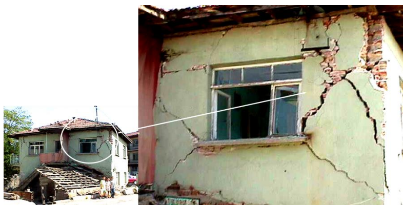
شکل ۳. ساختمان بنایی آسیب دیده با بازشوی بزرگ فاقد کلاف عمودی در زلزله ۱۷ آگوست ۱۹۹۹ ازبکستان. (ب. حسینی هاشمی ۲ )
