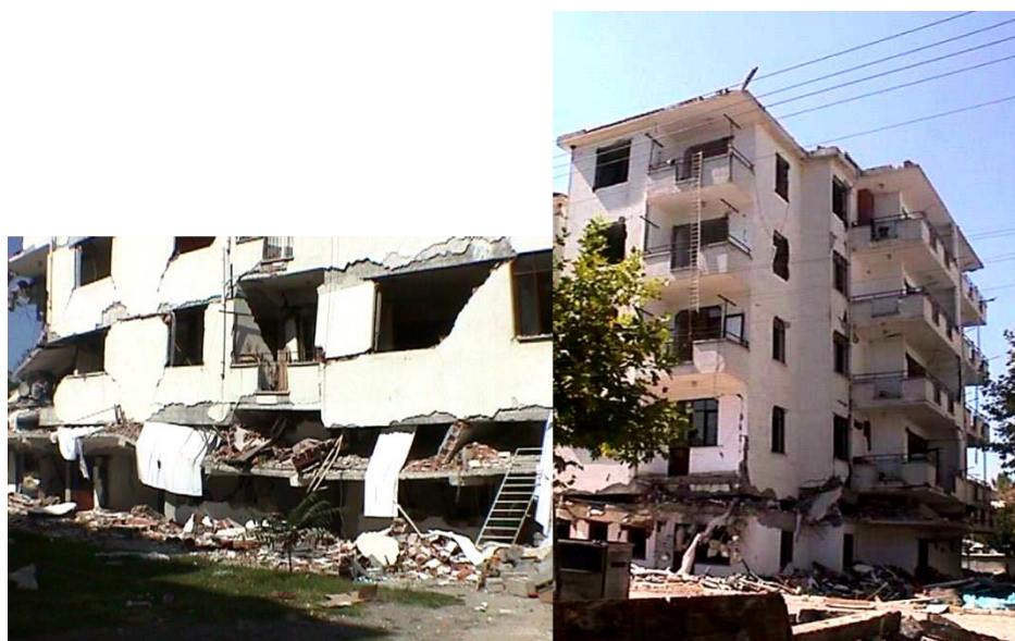
شکل ۶. شکست طبقه ضعیف در زلزله ۱۷ آگوست ۱۹۹۹ از میت ترکیه (ب. حسینی هاشمی ۴ ).
