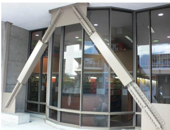
شکل ۵. دو مهاربند کمانش تاب برای مقاومت و میرا نمودن حرکات در یک زلزله.
