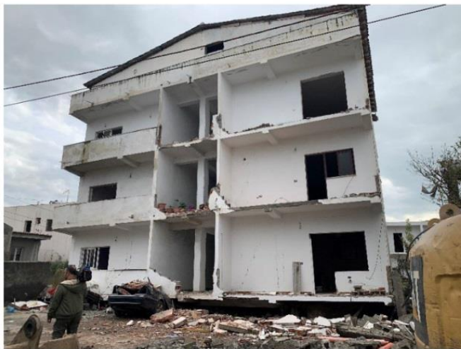
شکل ۴. انهدام کامل طبقه همکف در ساختمانی با طبقه نرم در یک زلزله متوسط (ان. و شو ۲ ).
